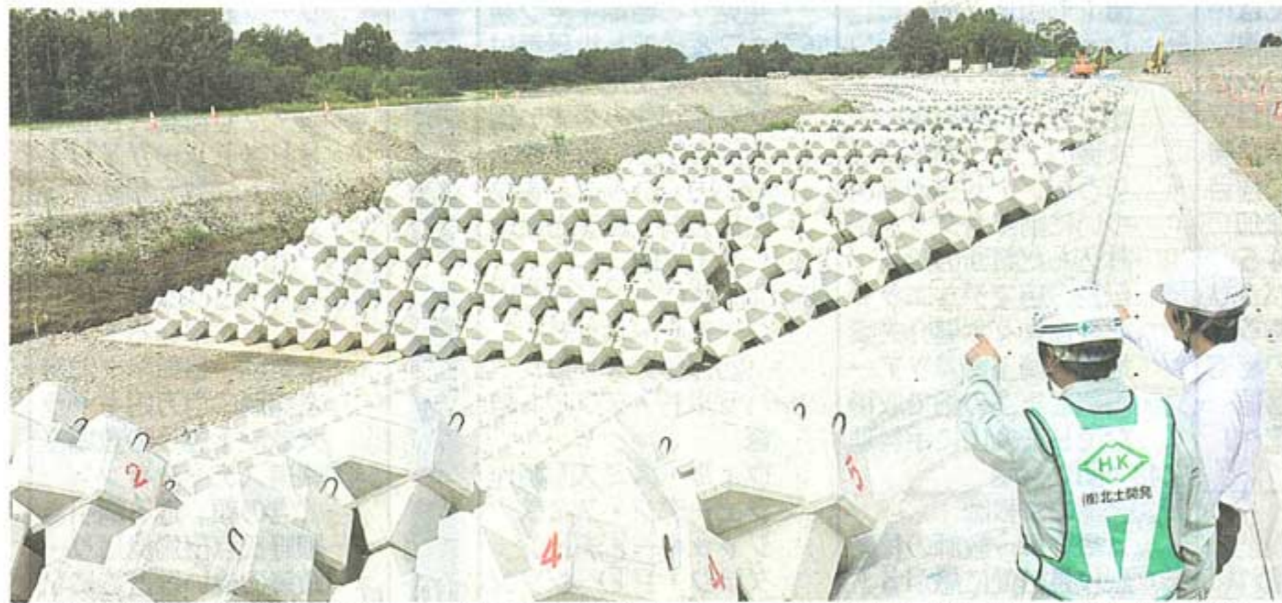
音更川の堤防流出箇所前面に整備されている護岸と水制工。音更川が左側、堤防が右側(5日、塩原真撮影)
